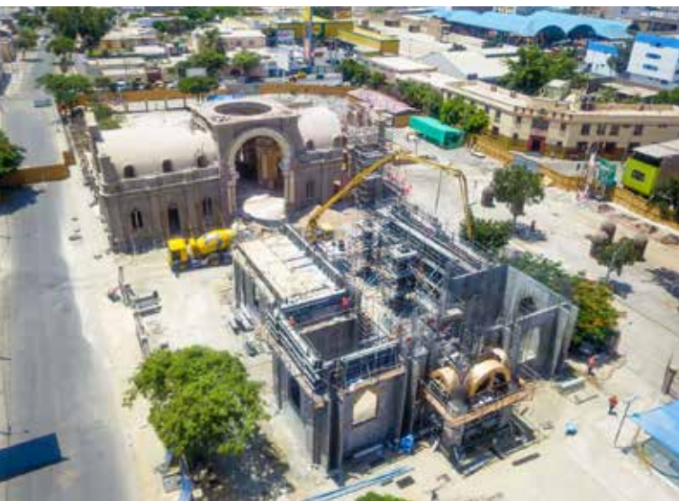
Para la construcción de esta obra se ha utilizado 3,400 m 3 de concreto armado y 330 toneladas de acero.
