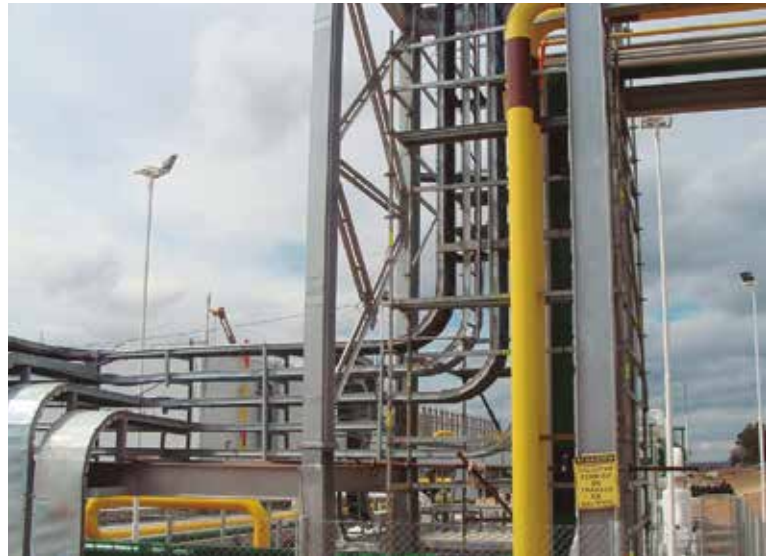
La empresa cuenta con bandejas portacables tipo escalerillas, granuladas, lisas con dimensiones variables.
