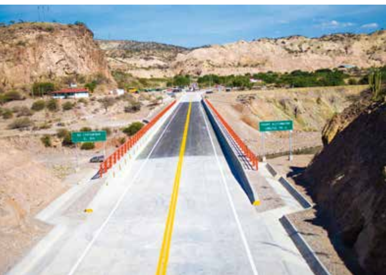
El tablero tiene un ancho total de 12.60 m y la calzada 6.60 m con 2 carriles de 3.30 m cada uno y bermas laterales de 1.20 m de ancho en ambos lados.
