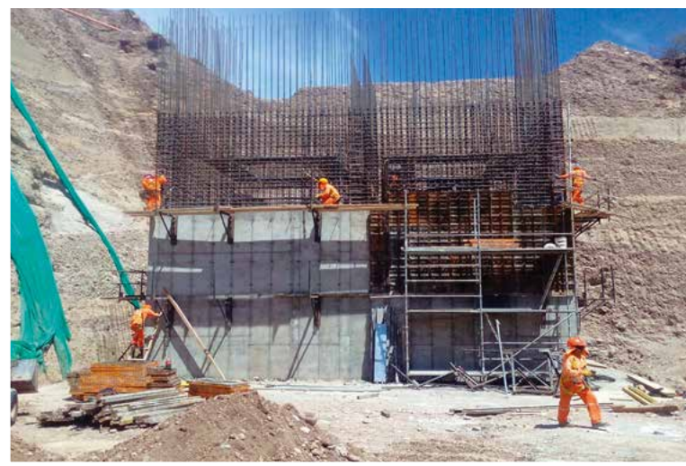
Los estribos tienen una altura de 18.30 m y están conformados por muros pantallas de concreto armado ( f_c=280 \text{ kg/cm}^2 ), de sección maciza.
