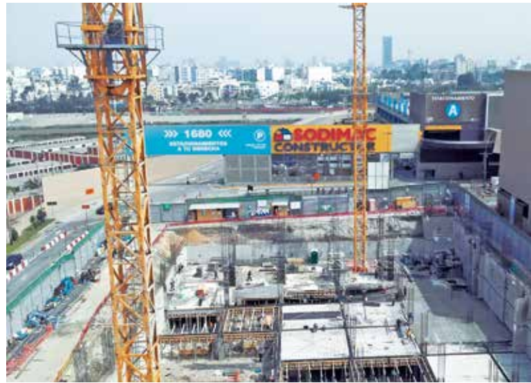
Los anclajes de la empresa han sido suministrados para obras tanto para el Estado como para el sector privado. Vista de la construcción de la ampliación del Jockey Plaza.
